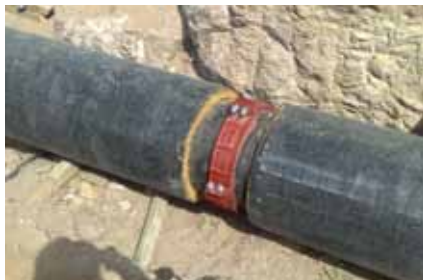
A 28 "R-88 de acoplamiento instalada en un sistema de agua helada
