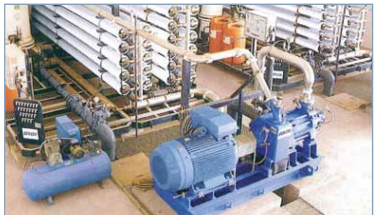
Planta de ósmosis inversa
