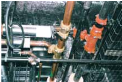
Una válvula de mariposa SJ-300 instalada en un sistema de agua caliente
