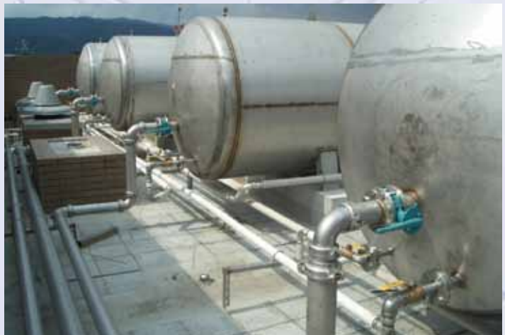
Sistemas de Aire Acondicionado, Ventilación y Calefacción, la Universidad Tamkang, Lanyang, Taiwán
