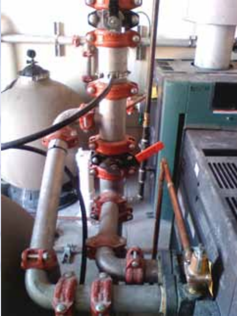
Holiday Inn Piscina, el cuarto de bombas, Las Vegas, NV
