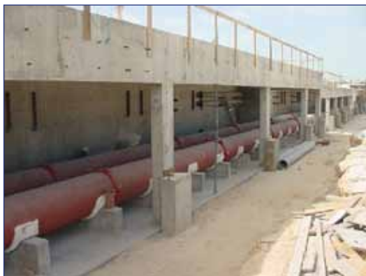
Líneas de agua de enfriamiento de 30"
