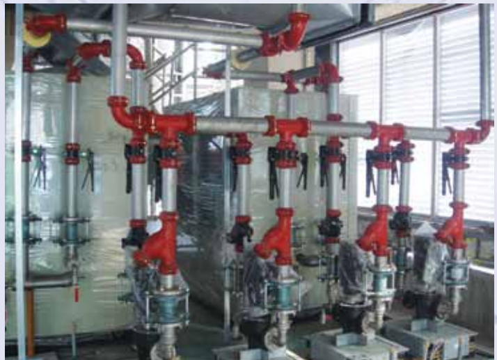
Sistemas de Aire Acondicionado, Ventilación y Calefacción, Tecnología de la Construcción Siete Estrellas, Taipei, Taiwan
